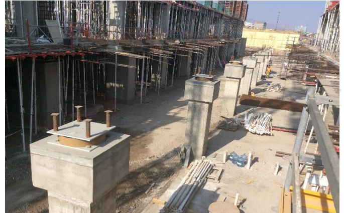
Dispositivos instalados en edificio UPC
