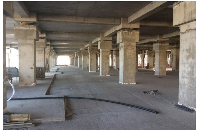
Avance en la colocación de hormigón en edificio Unidad de Pacientes Críticos UPC
